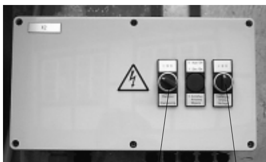
J.2 kép: Adagolószivattyúk kezelőablaja
