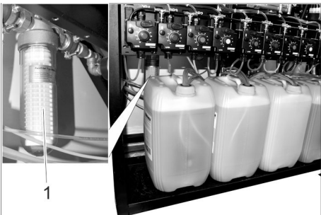
1 Filtre de la pompe antigel
