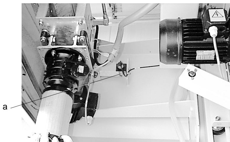
Fig. F.3 Coluna 1 em cima a interruptor final para oscilar a travessa das escovas laterais
